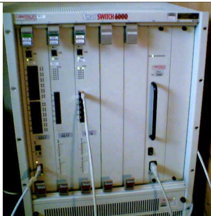
Switch s třemi síťovými moduly a zdrojem.
